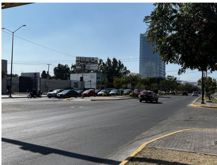
Imagen 10. Estado del pavimento del Blvd. Morelos carril lateral.
