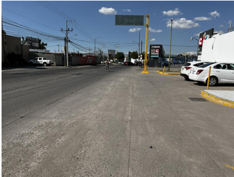
Imagen 11. Estado del pavimento del Blvd. Transportistas
