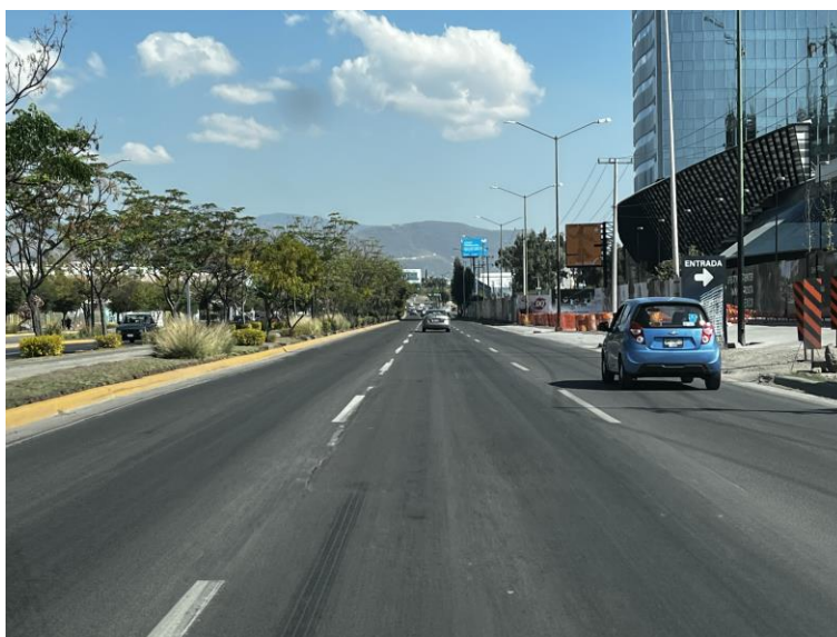
Imagen 9. Estado del pavimento del Blvd. Morelos.
